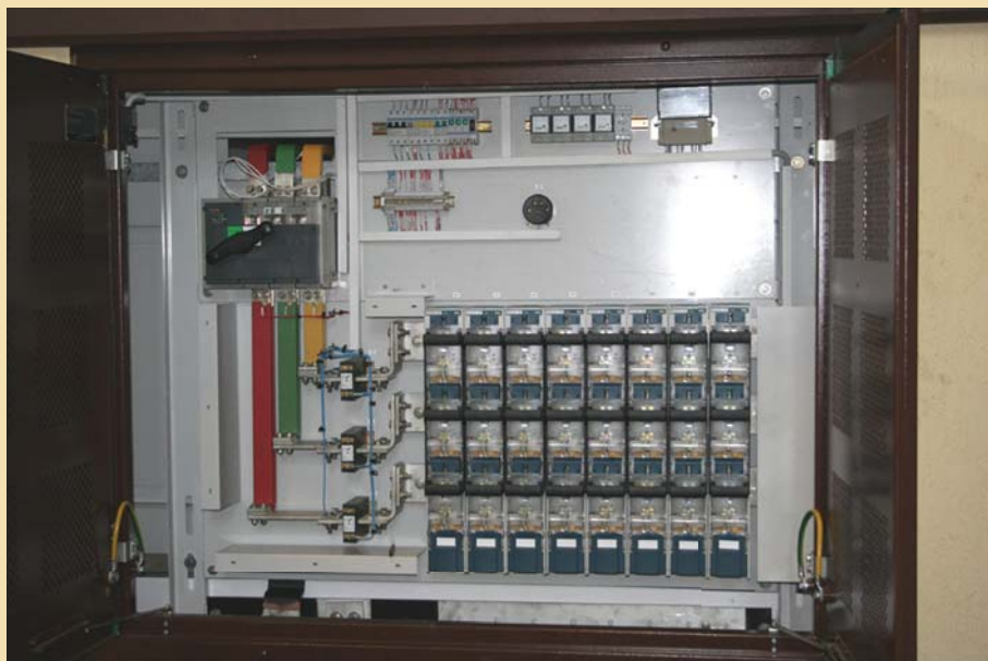
Отсек распределительного устройства низшего напряжения (РУНН)
